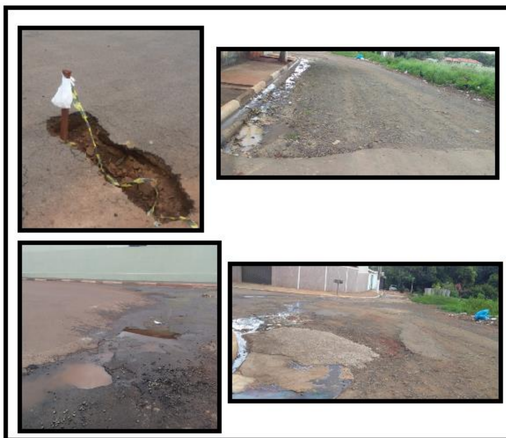
Figura 29: Falta de manutenção em vias alifáticas
